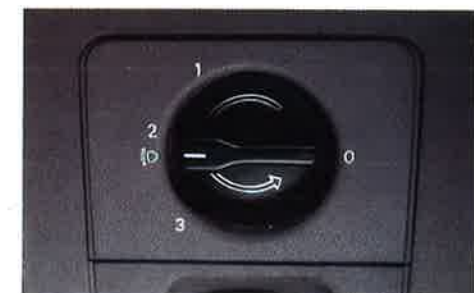
Commandes de réglage en site des projecteurs.
